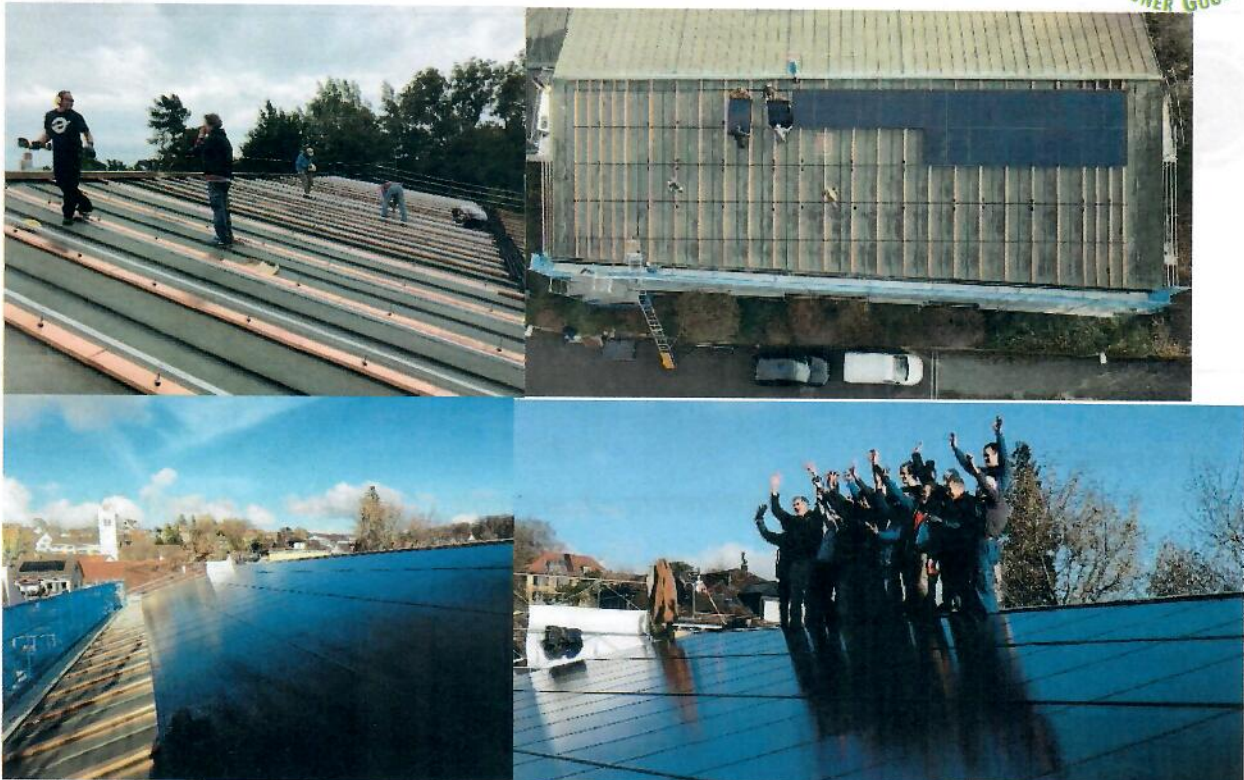
Abbildung 2: Gemeinsam zur Photovoltaik, von oben links nach unten rechts: Die Trägerstruktur steht – Aus der Luft – Fast fertig – Jubel. Bilder: Niels Engeli (rechts oben), Almut Jödicke (Rest)
